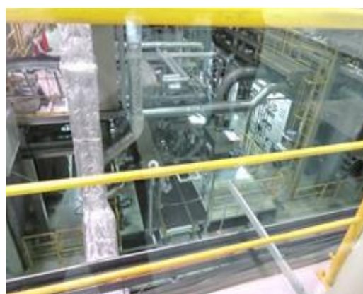
(PCB 分離の真空加熱設備)
